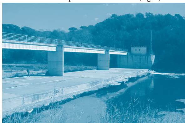
Figura 5. Foto de la estación de aforos de Can Simó el año 2002. Obsérvese la gran erosión local debida al salto de agua, inducido por la erosión general
