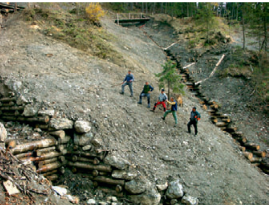
Abb 5 Vom Forstbetrieb ausgeführter Hang- und Bachverbau im Mühliwald, Engelberg.
