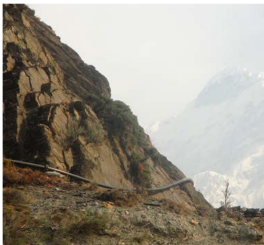
Dommages subis par les tuyaux sur les pentes raides
