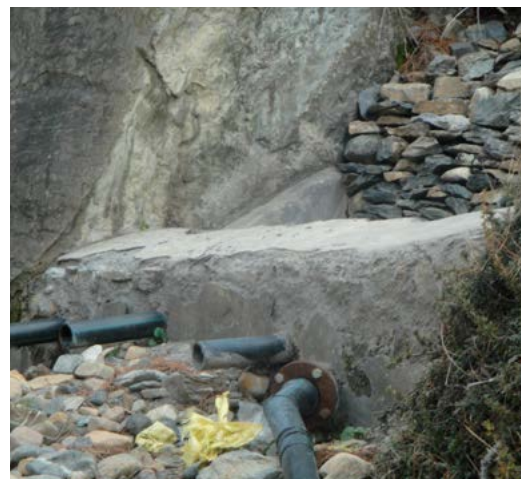
En raison de l'épuisement des eaux souterraines, la source et la structure de prise d'eau associée sont plus basses
